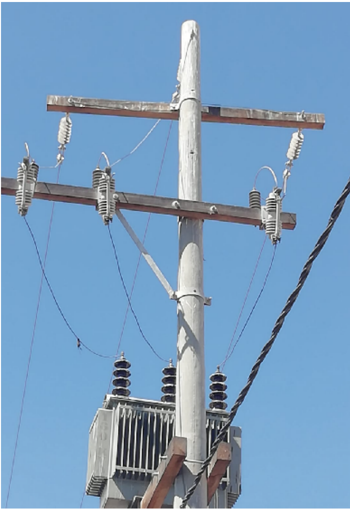
Figura 2. Poste de transmisión eléctrica de media tensión trifásica con dos líneas muy próximas. Foto: César Ortiz.
